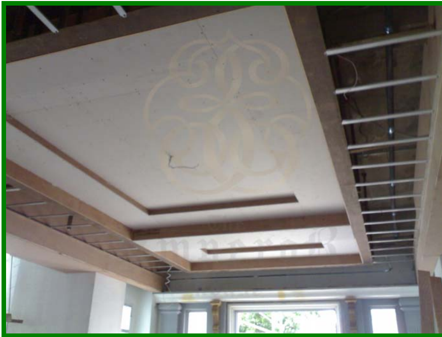
งานกรุปิดแผ่นฝ้าเพดานยกเสตีปภายใน บริเวณโถงทางเข้า
