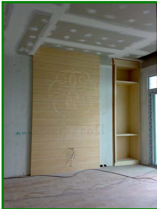
งานกรุปิดแผ่นไม้ และตู้โชว์ของบริเวณหัวเตียง ภายในห้องนอนลูกสาว
