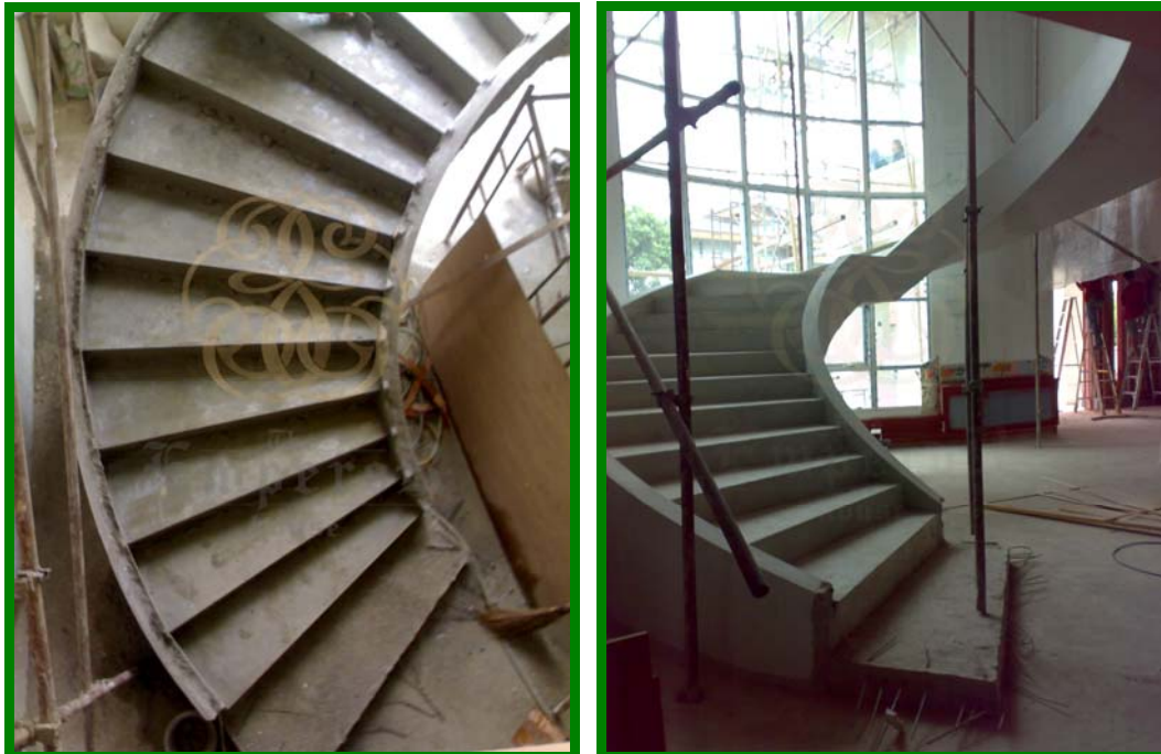
งานโครงสร้างบันไดทางขึ้นชั้นที่ 2 รูปทรงเวียนโค้ง ระหว่างกรุผิวพื้นไม้สัก รองงานติดตั้งลูกกรงเหล็กตัดอิตาลี
